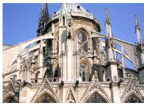
Arcs boutants extérieurs de la Cathédrale Notre-Dame de Paris construite à partir de 1163.
