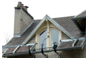
Remarquable gouttière en fer forgé de l'hôtel Jassedé, soutenue par un appareil de ferronnerie simulant des torches.
