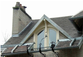
Remarquable gouttière en fer forgé de l'hôtel Jassedé, soutenue par un appareil de ferronnerie simulant des torches.
